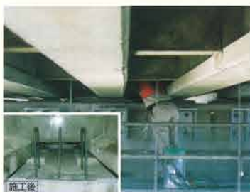
変位制限構造用LFアンカー施工状況 (神宮橋P65橋脚)
